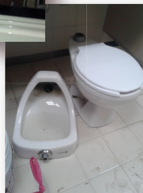
Muebles sanitarios de bajo consumo de agua
